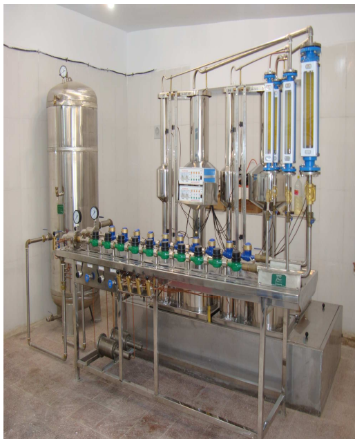
شکل (2): کارگاه تست کنتورهای مشترکین
