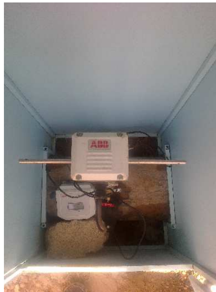
شکل (3): فلومتر نصب شده در ورودی ناحیه
