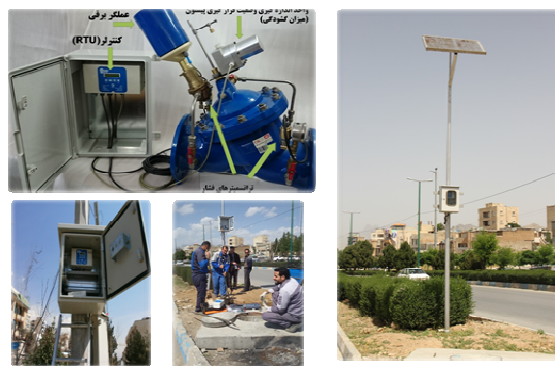
شکل (۸): نمونه ای از نصب شیر های فشار شکن هوشمند در شهر خرم آباد
