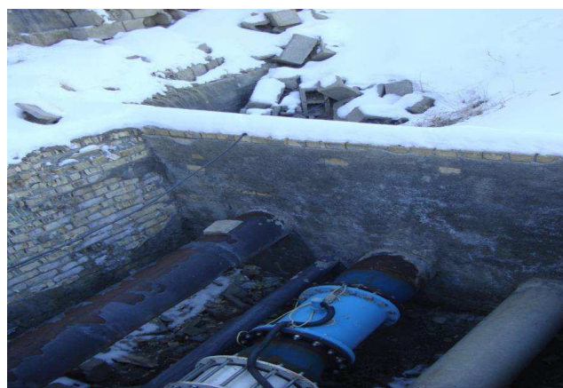
شکل (۳): ساخت منهول نامناسب فلومتر الکترومغناطیسی (منهول بدون دال است)
