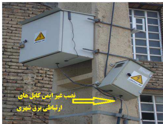
شکل (۵): نصب غیر ایمن و بدون محافظ کابل های ارتباطی تابلوی دستگاه کنترل گر فشارشکن و برق شهری
