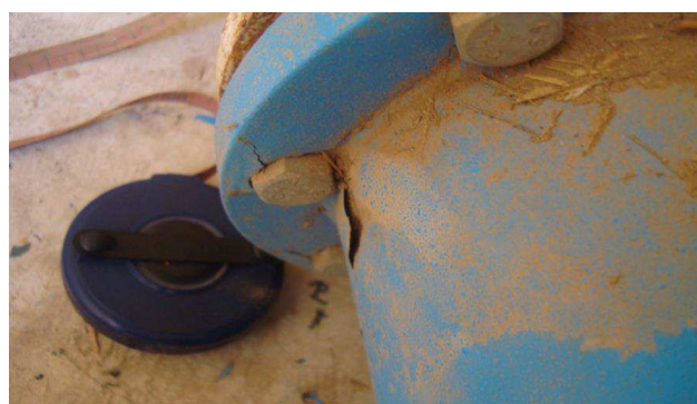
شکل (۴): کیفیت نامناسب سنسور و نحوه نامناسب نصب سنسور فلومتر الکترومغناطیسی
