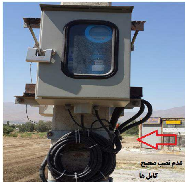
شکل (۲): عدم نصب صحیح کابل نمایشگر دستگاه فلومتر الکترومغناطیسی (فلومتر DMA)
