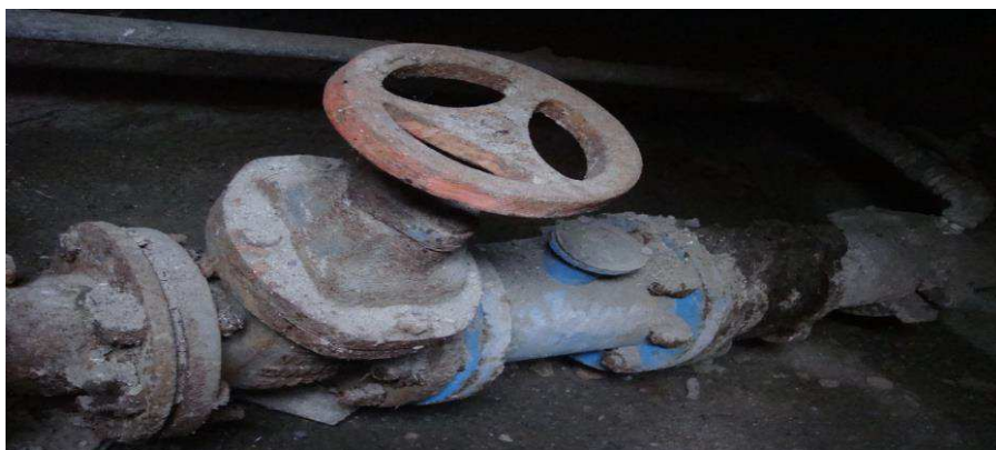
شکل (۶): عدم نگهداری مناسب از سنسور فلومتر الکترومغناطیسی
