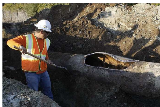
شکل (۱): نشت آب در اثر ترکیدگی و بروز خرابی در خطوط انتقال و شبکه های آبرسانی تنها یکی از عوامل افزایش آب بدون درآمد محسوب می شود
